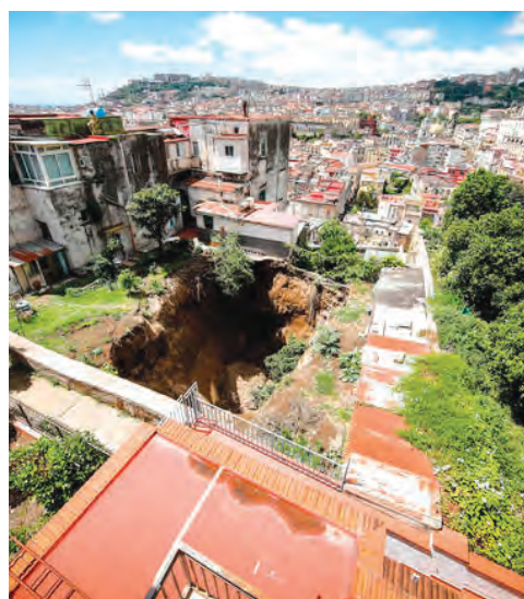
Lavoro eseguito a Napoli, quartiere Sanità, dallo spin off Terre Leggere Srl per conto del Genio Civile. Isoltech Srl si trova a Verdellino (Bg) - www.isoltech.it
