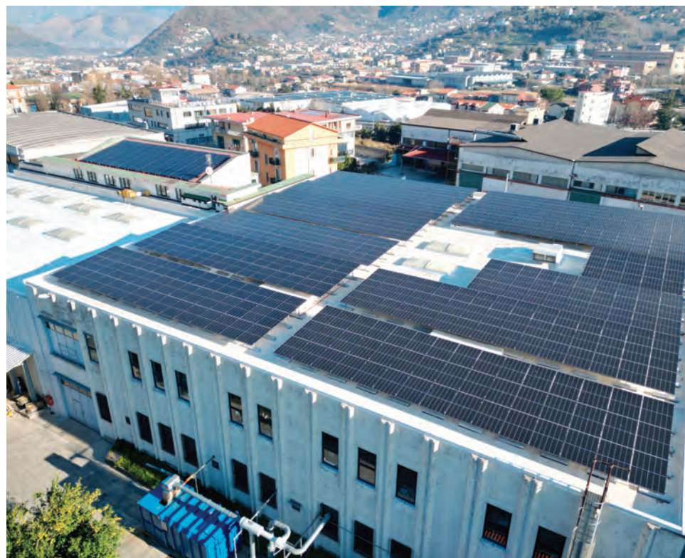
Azienda Imag Spa -realizzazione impianto fotovoltaico da 230Kw
